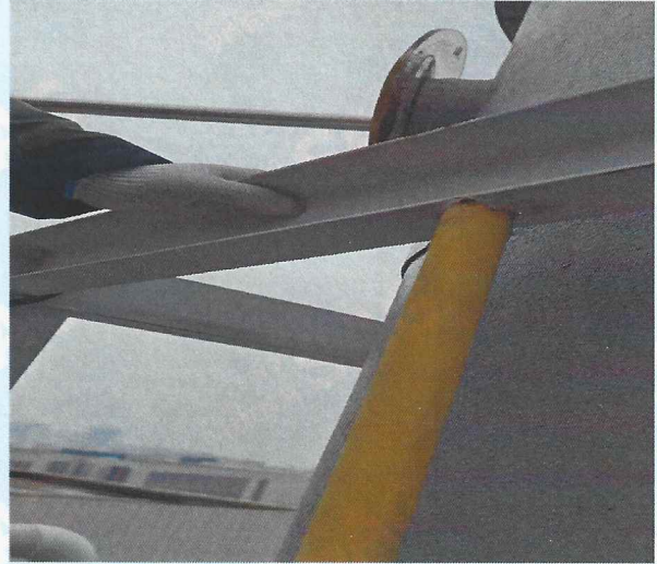
DA011 酸性废气排口
